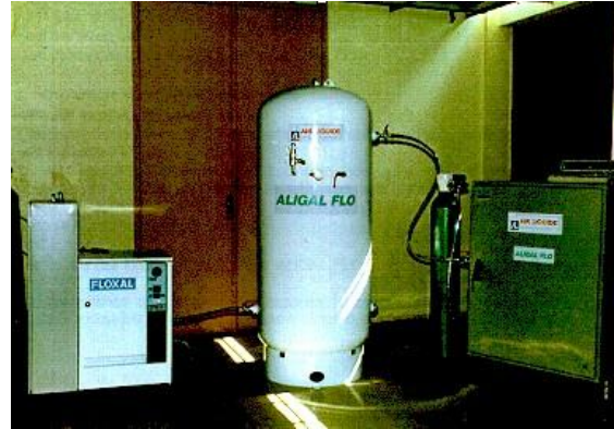
Générateurs d'azote « sur site »
